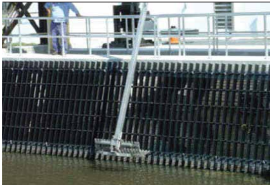
Rejas que muestran la corrosión debido al impacto.
